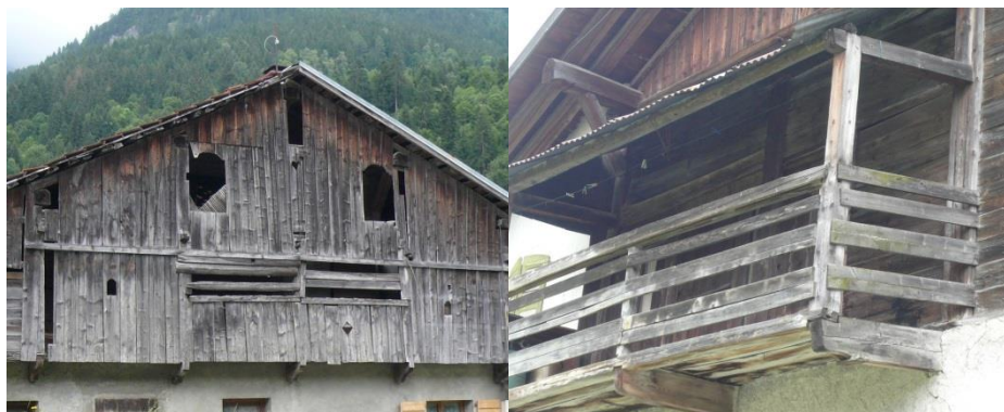
Tresse, loge, trous d'aération
