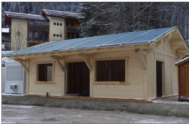
Le nouveau bâtiment de la patinoire est en cours de construction. Photo Le D.L.A.D.
